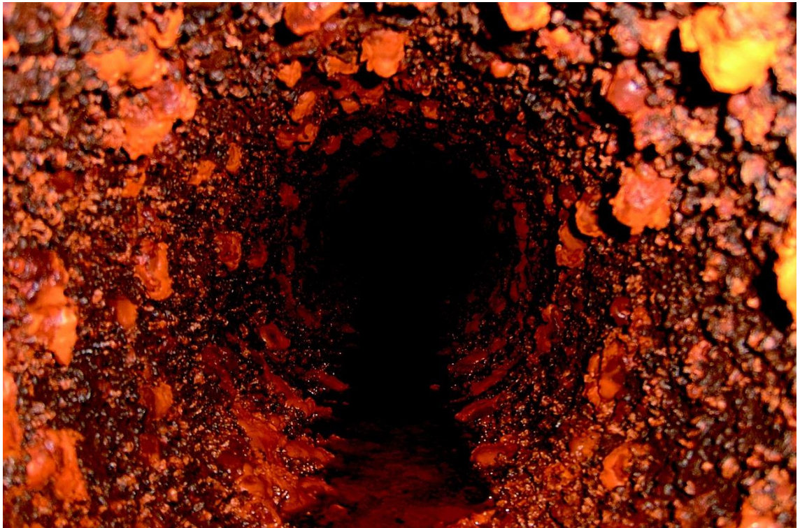
Kuva 1. Veden happamuus näkyy vesiputkissa korroosiona. (Pixabay.com, 2017)
