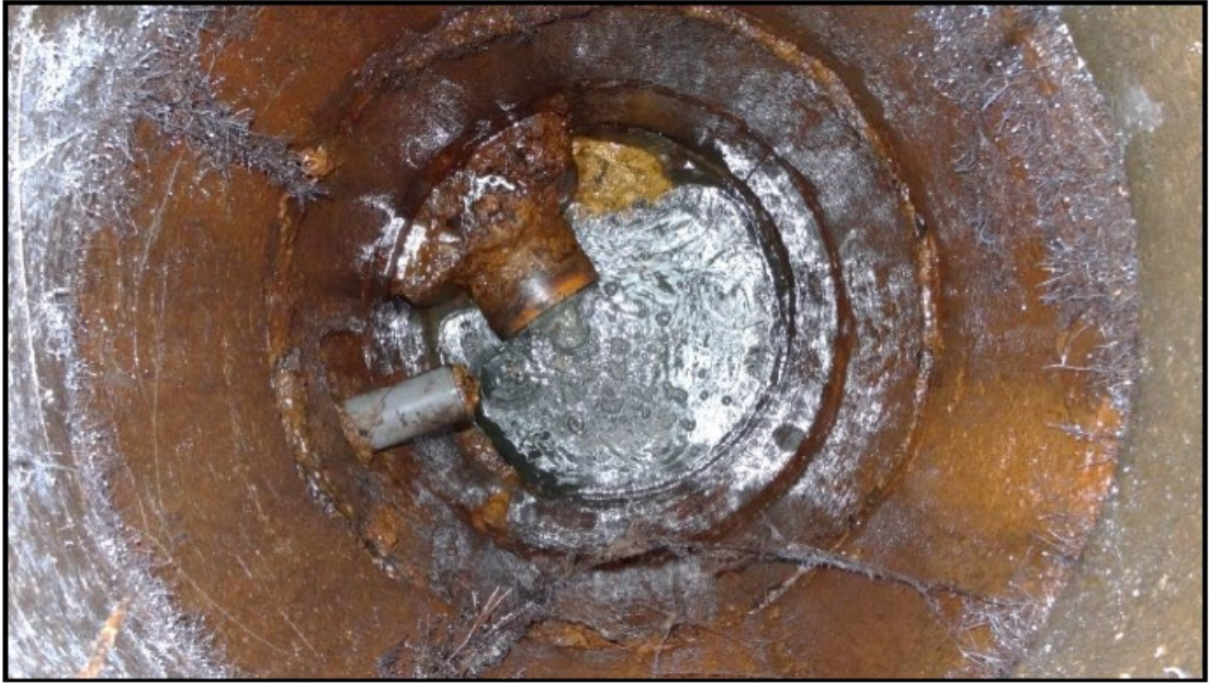
Kuva 8. Liittymien kohdalta vuotava kaivo, johon on tunkeutunut juurikasvustoa (Tammenlarva 2015).
