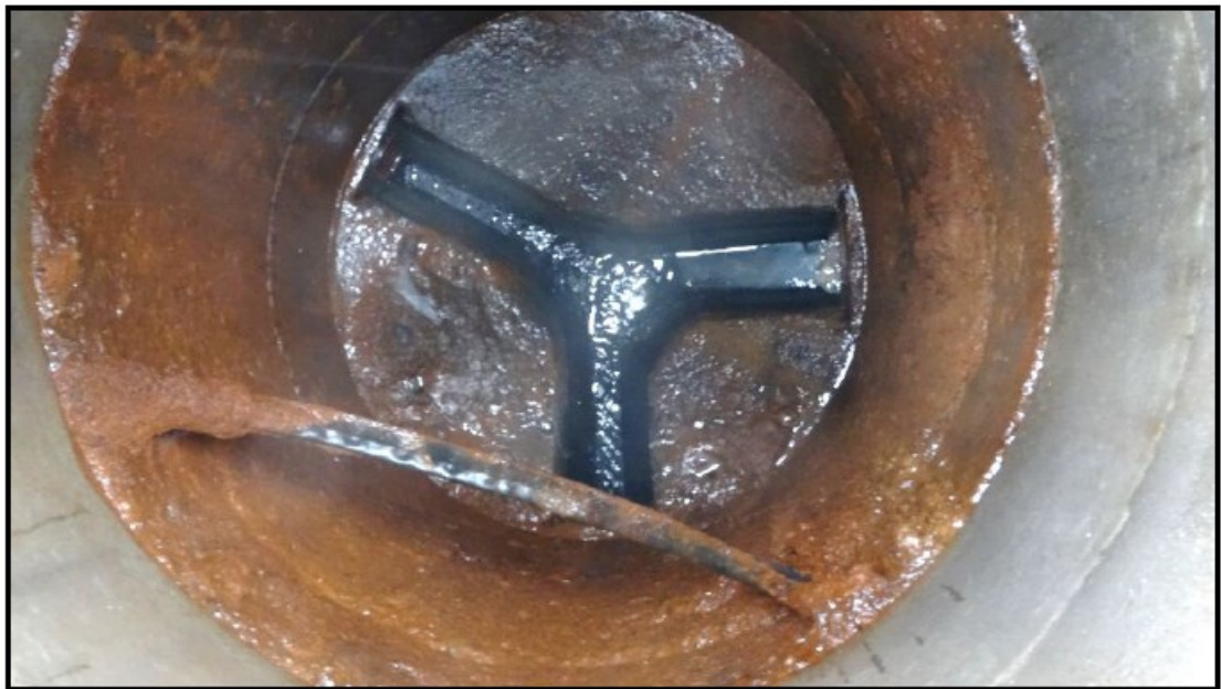
Kuva 6. Saumoista vuotava betonikaivo, josta on irronnut tiivisterengas (Tammenlarva 2016).
