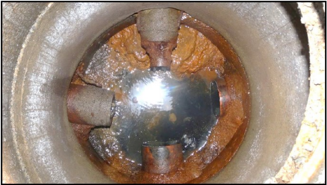
Kuva 5. Viallisia, vuotavia tonttiliittymiä, joiden liitosreiät on tehty kaivon jälkeinpäin lekalla lyömällä (Tammenlarva 2016).
