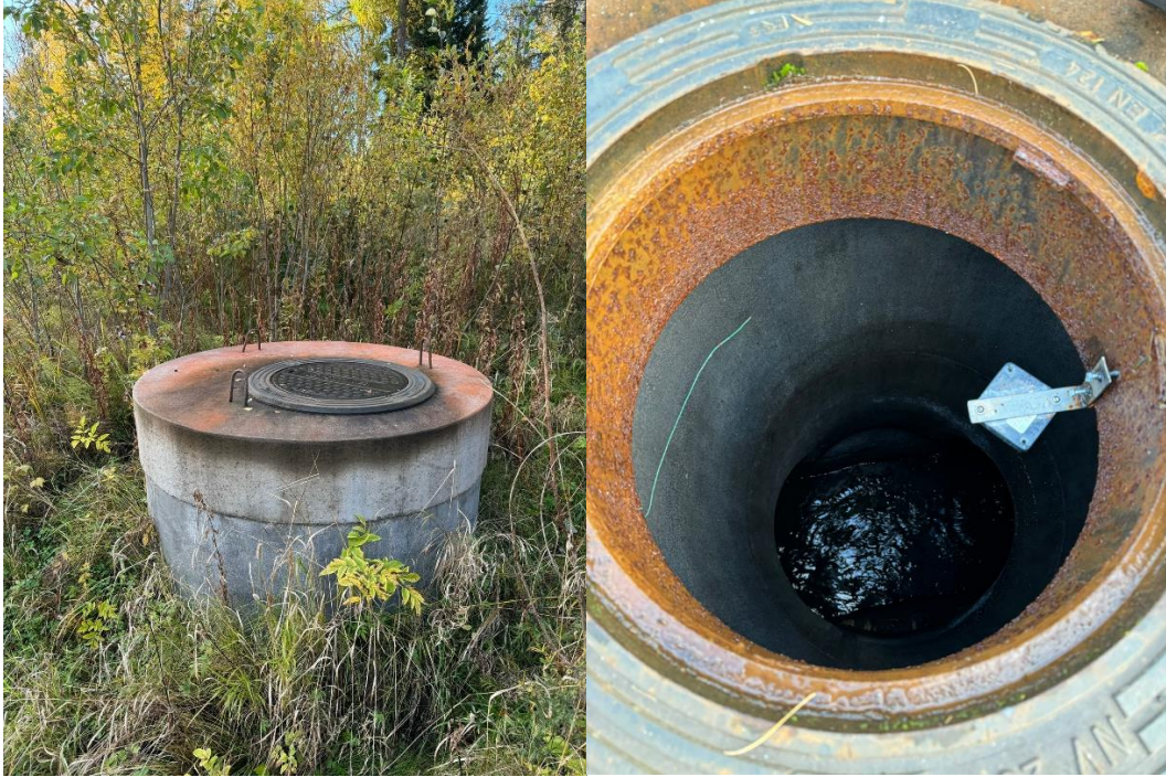
Kuva 7. Kaivo 1 kokonaisuudessaan sekä pinnanmittausanturi asennettuna.
