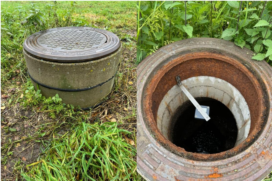
Kuva 8. Kaivo 2 kokonaisuudessaan sekä pinnanmittausanturi asennettuna.
