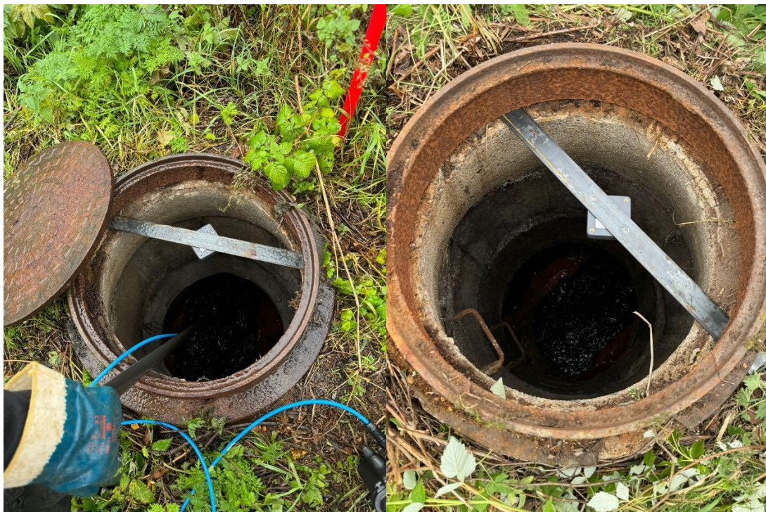
Kuva 10. Kaivo 4 kokonaisuudessaan virtausmittauksen aikana sekä pinnanmittausanturi asennettuna.
