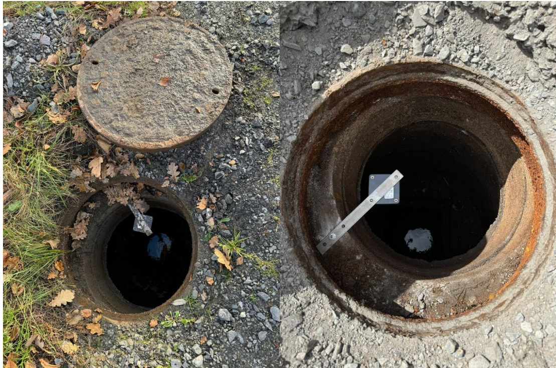
Kuva 9. Kaivo 3 kokonaisuudessaan sekä pinnanmittausanturi asennettuna.
