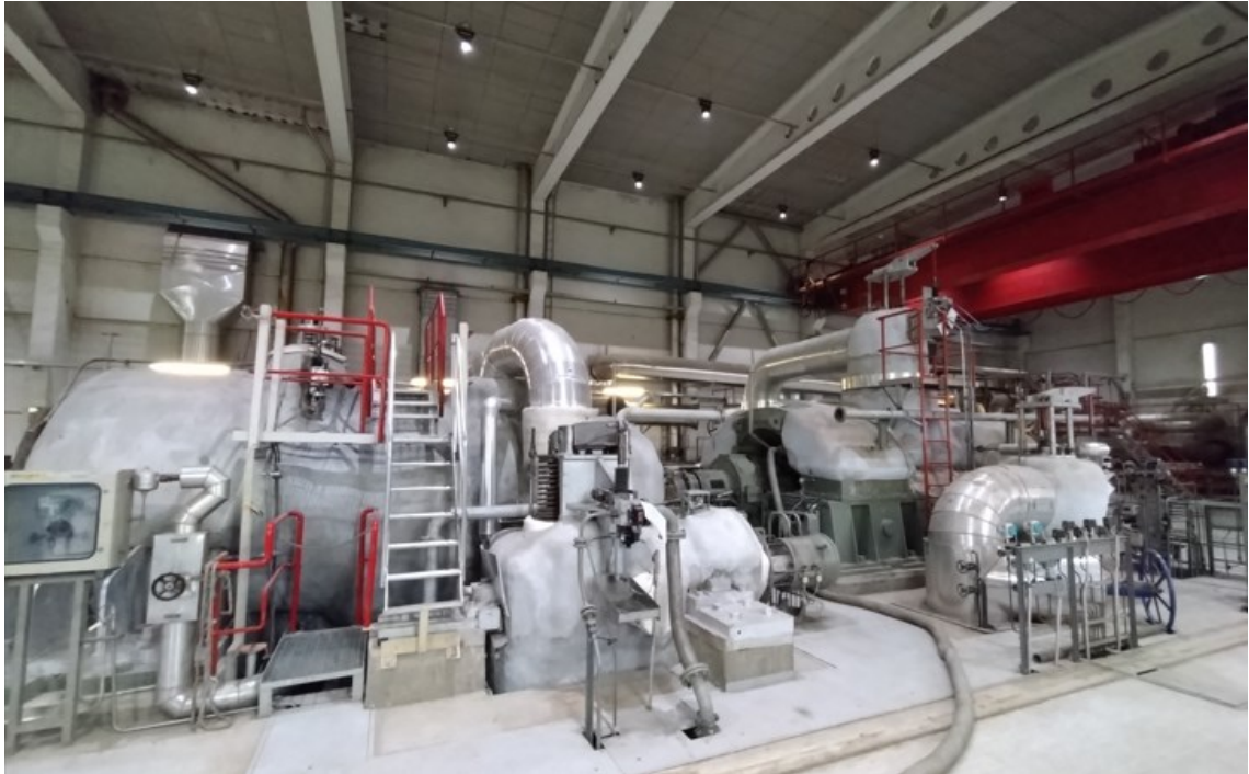
Kuva 8. Turbiinihuone, jossa vasemmalla vastapaineturbiini ja oikealla lauhdeturbiini.
