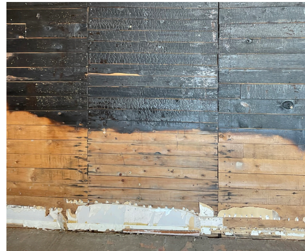
Kuva 34. Konttorirakennuksen sisällä olevia tuhopolton yrityksen jälkiä.
