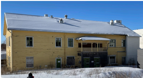
Kuva 45. Pääjulkisivu keväällä 2023. Kuistin tuhopolttoyritys ja kunto huomattavissa
