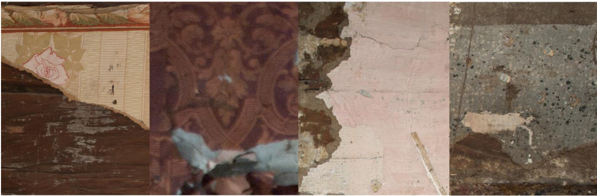
4 3 2 1 Kuva 65. Huoneiden 103 ja 104 satunnaisia tapetti- ja maalikerroksia
