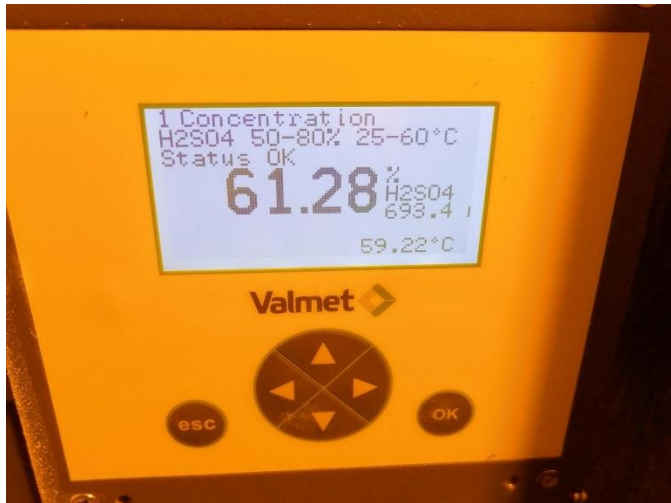
Kuva 23. Paikallisnäyttö puulauksen aikana.
