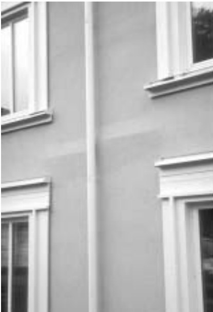
Kuva 4.5.2.5 Ruotsin Wälluddenin puukerrostalon rappaus on pullistunut rakennusrungon painumisen vuoksi.
