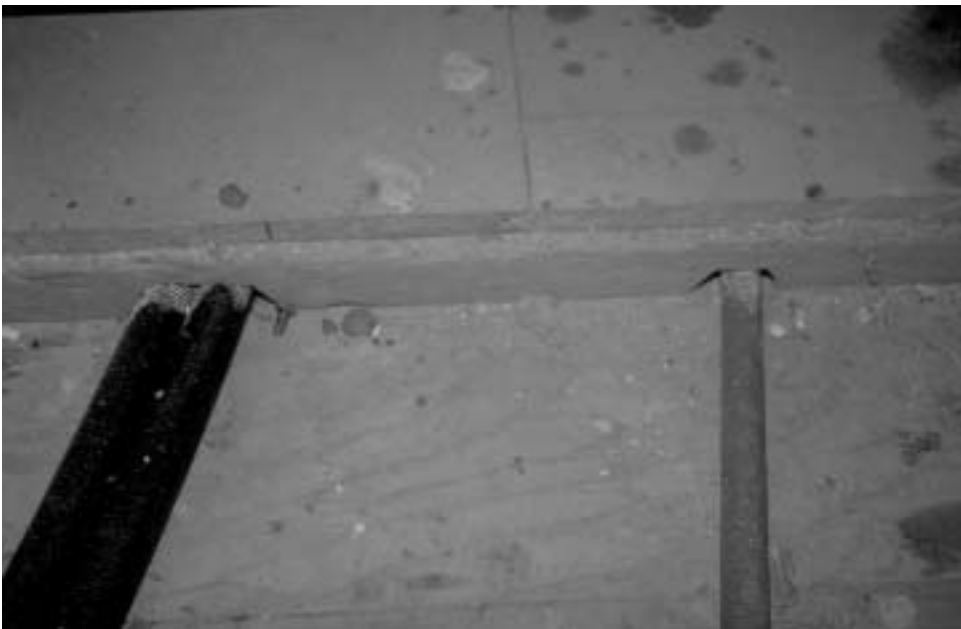
Kuva 7.3.2 Lämpö- ja vesilinjoja uppoasennuksina Kiinteistö Oy Puukotkan uivan pintalattian villakerroksessa.
