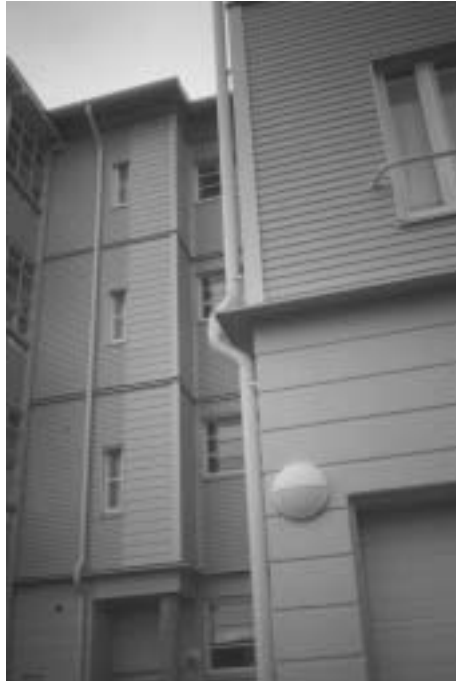
Kuva 9.2.2.1 Suomen ensimmäiset puukerrostalot ovat olleet ulkoasultaan varsin maltillisia. Ovatko ne saaneet ulkoasunsa liiaksi vallitsevasta betonikerrostalotuotannosta? Kuvassa Porvoon toinen puukerrostalo, As Oy Aleksanterinkatu 29.
