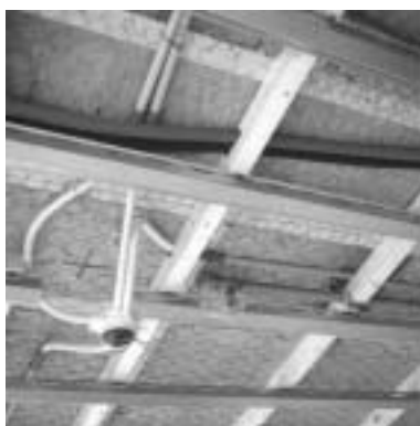
Kuva 5.4.5 Puuvälipohjan alapuolisia metallisia akustorankoja.
