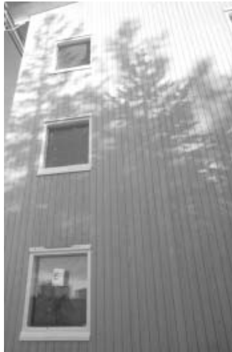
Kuva 3.4.1.2 Oulun Kiinteistö Oy Puukotkä on toteutettu ilman näkyviä palokatko- ulokkeita.
