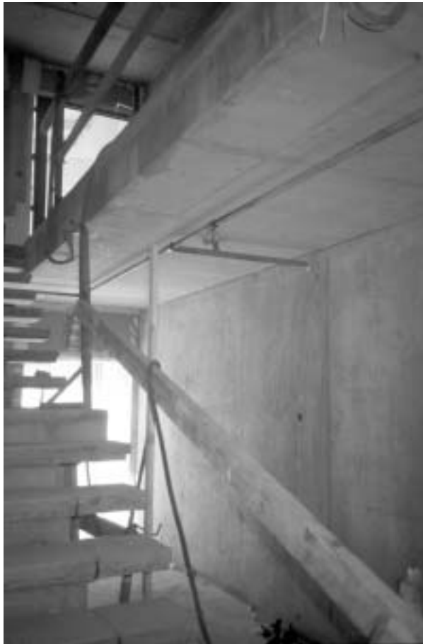
Kuva 3.2.3.4 Häätävarjelen liioittelua? Oulun Puu-Linnanmaalla myös betonirunkoisten kerrostalojen porrashuoneet on sprinklattu puujulkisivujen vuoksi. RakMK E1:n noudattaminen edellyttää tätä.
