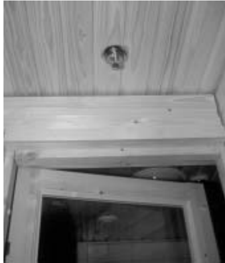
Kuva 7.6.2.2 Sprinkleriverkoston pintasuutin Kiinteistö Oy Puukotkan asuntosaunassa.
