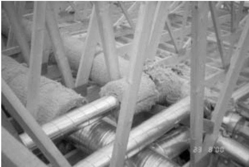
Kuva 7.4.1 Ilmanvaihtoasennuksia puukerrostalon ullakkotilassa. Ristikkoyläpohjissa asennusteknisenä ongelmana on tukevan työalustan puuttuminen.
