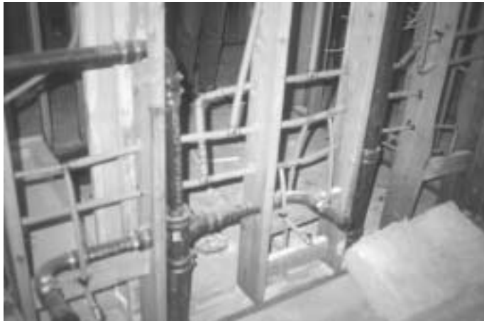
Kuva 7.1.1 Amerikkalaisessa puukerrostalorakentamisessa LVIS-reititykset näyttävät erittäin vaikeilta. Rungon lävistyksiä ja johdotusten liitoskohtia syntyy tarpeettoman paljon.
